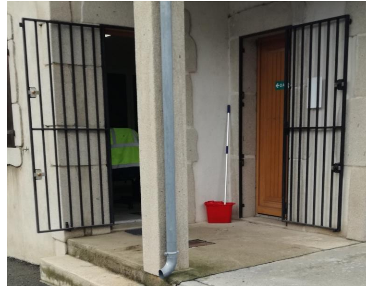
Grille de protection pour les portes du local des agents
