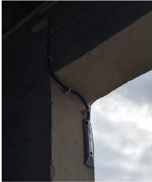
Détecteur d'ouverture dans le local D3E
