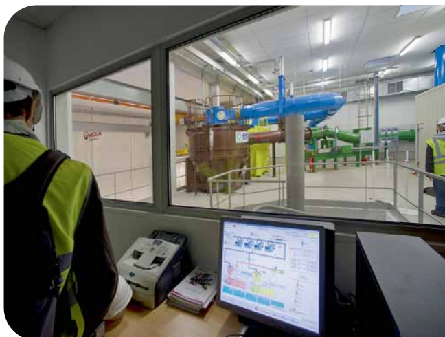
Salle de commande du terminal – unité de collecte pneumatique des déchets – Romainville.
