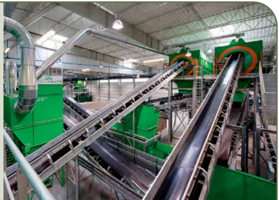
Unité de tri, pré-traitement et compostage de GDANSK – Groupe Vauché Europe.
