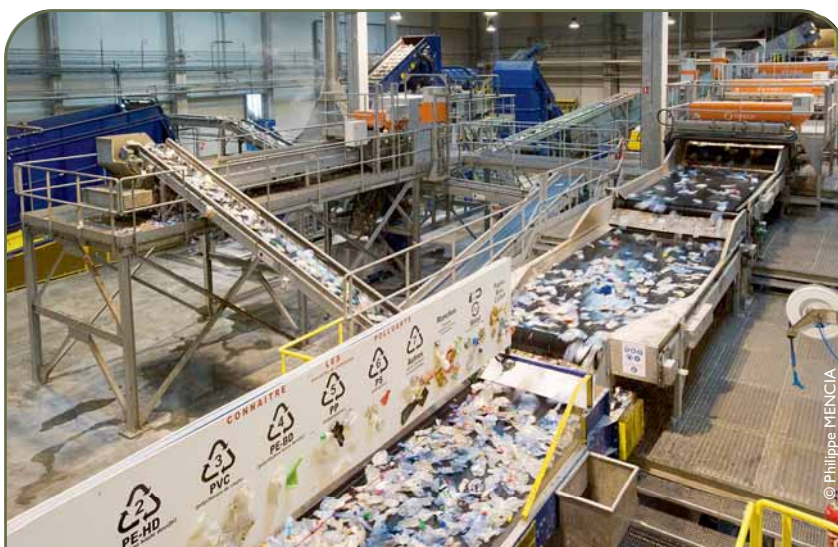
Usine France Plastiques Recyclage – Tri optique.
